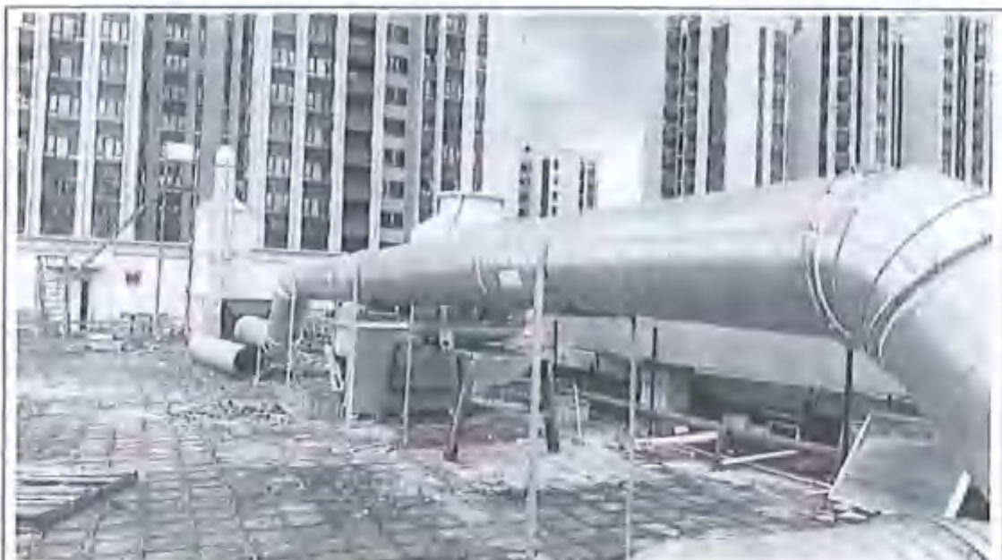
图 3-2 废气处理设施
