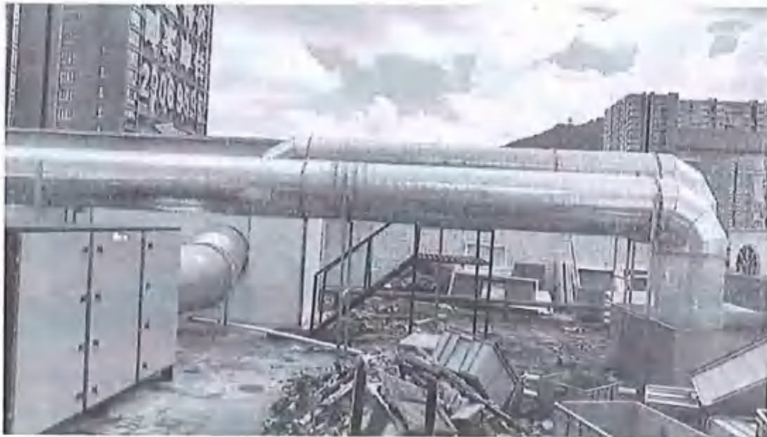
图 3-1 废气处理设施
